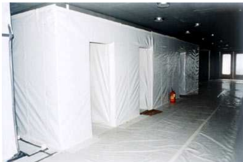
Fot. 1. Widok pomieszczenia zabezpieczonego folią PE, w którym wykonywane będą prace związane z usuwaniem azbestu z zastosowaniem podciśnienia (źródło: www.algader.pl )
